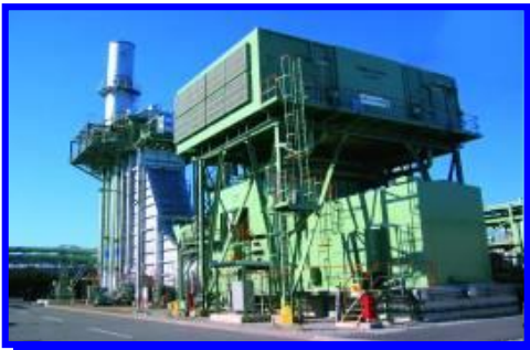
大阪ガス姫路発電所
