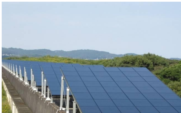
太陽光発電所
