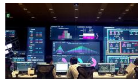
日本橋エネルギーセンター
