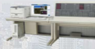
中央監視設備
